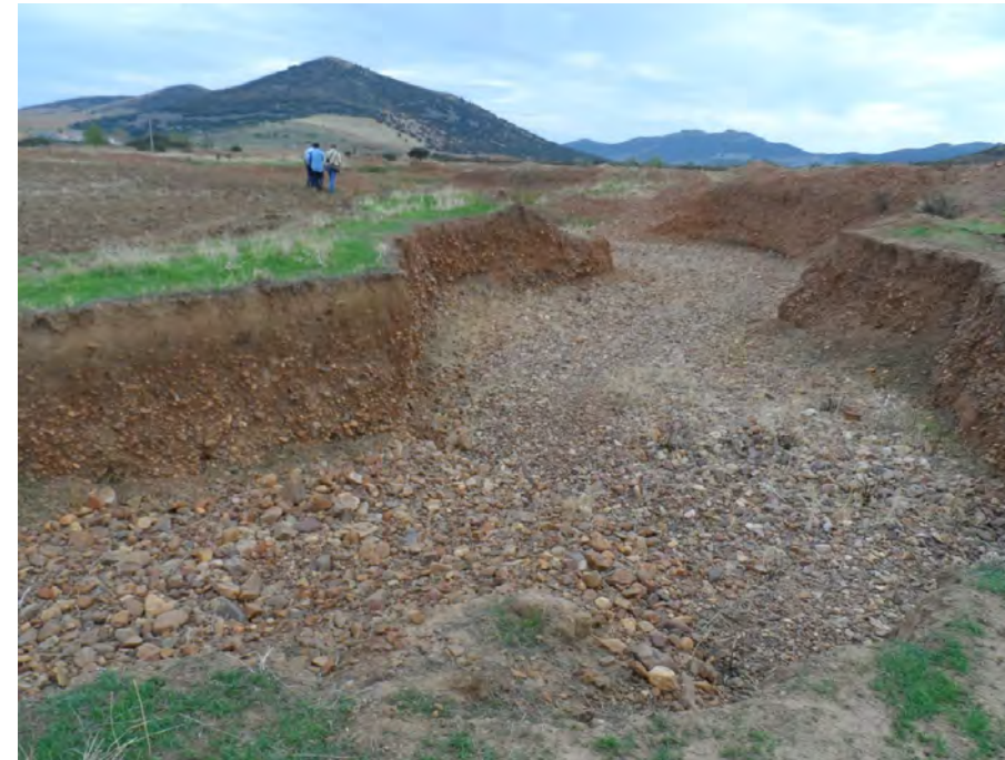
Figura I. Situación inicial de la gravera Charco del Tamujo, antes de las labores de restauración. Autoría: Cinclus Soluciones S. L.
