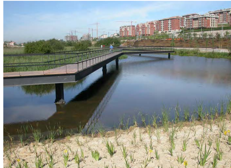
➤ Figura I. Vaguada de Las Llamas, trabajos iniciales. Autor: Felipe González (SEO BirdLife).
