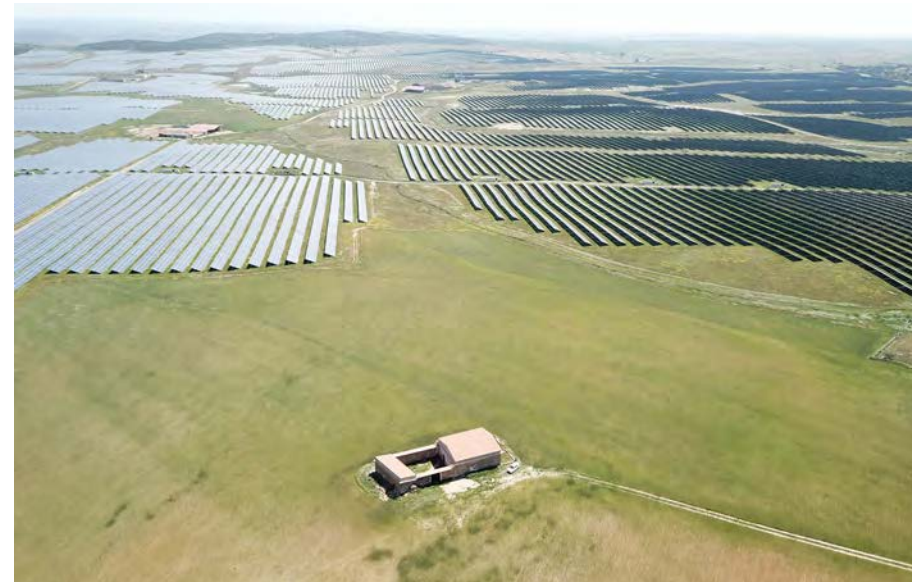
Figura 1. Vista aérea de la planta fotovoltaica Núñez de Balboa. Autoría: Iberdrola.
