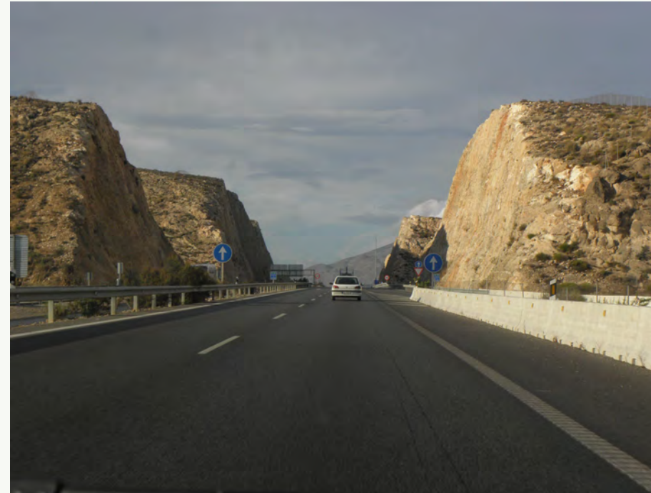
> Figura VII. A la izquierda una carretera comarcal en pleno corazón de la sierra de Gredos (Hoyos del Espino, Ávila), construida a principios del siglo XX. Se puede apreciar cómo se adapta al relieve mediante un trazado sinuoso. A la derecha una autovía del siglo XXI, donde la plataforma de la infraestructura se impone sobre esta sucesión de laderas (A-7, Almería). Autor: Ignacio Mola.
